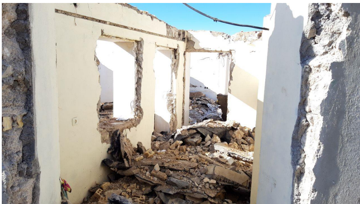
شکل ۴- تخریب خانه ها بر اثر زلزله در شهر سی سخت
