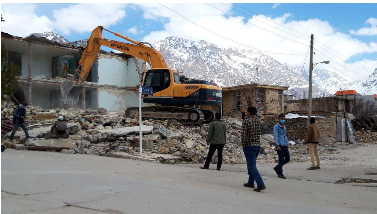
شکل ۵-تخریب خانه ها بر اثر زلزله در شهر سی سخت
