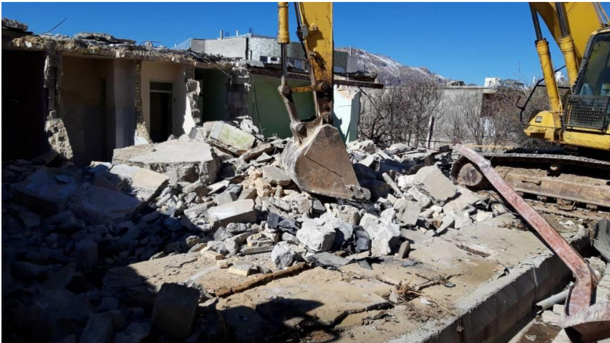
شکل ۲- تخریب خانه‌ها بر اثر زلزله در شهر سی سخت
