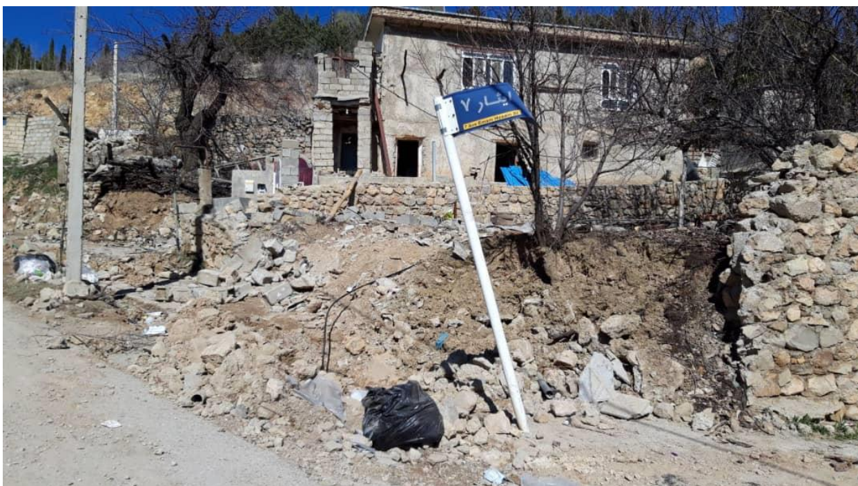
شکل ۳- تخریب خانه ها بر اثر زلزله در شهر سی سخت
