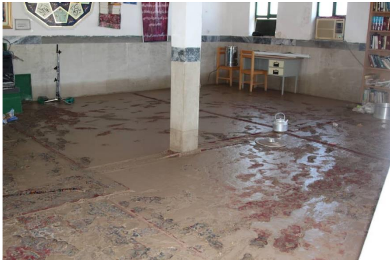
تصویر ۱۶-گل گرفتگی ساختمان‌ها در روستای زیارت
