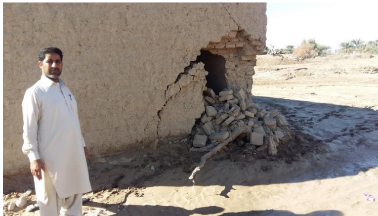
تصویر ۱۳- تخریب منازل در روستای چاه دنوک
