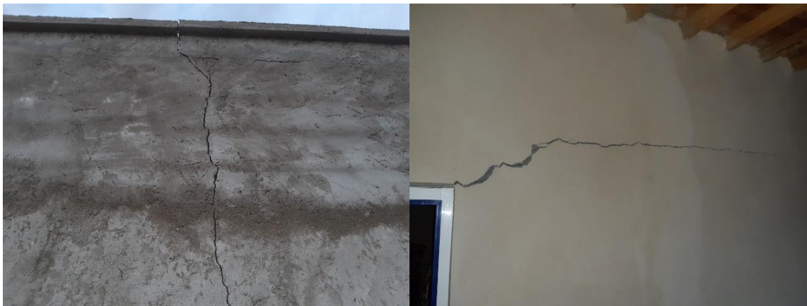
تصویر ۶۱- ترک دیوار در منازل روستای سرخکوه
