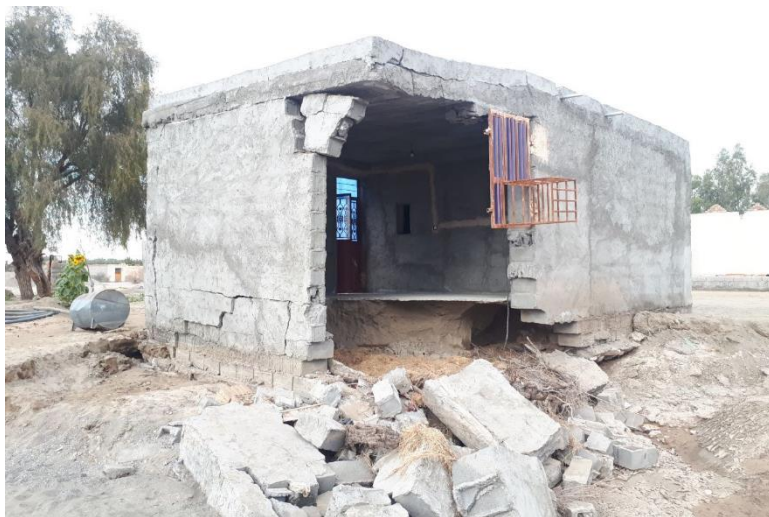
تصویر ۱۴-تخریب منازل در روستای زیارت باقرآباد
