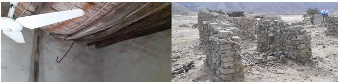
تصویر ۳۳- تخریب منازل در روستای جموک
