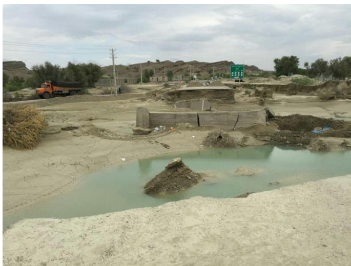
تصویر ۵۵- تخریب جاده‌ها در شهرستان گابریک
