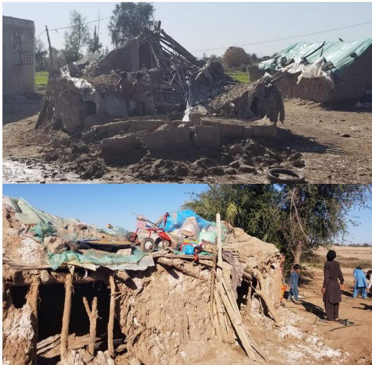
تصویر ۴۷- تخریب منازل در روستای تکل حسن
