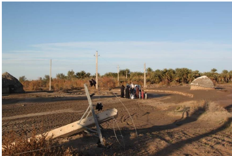
تصویر ۶- تخریب تیرهای برق
